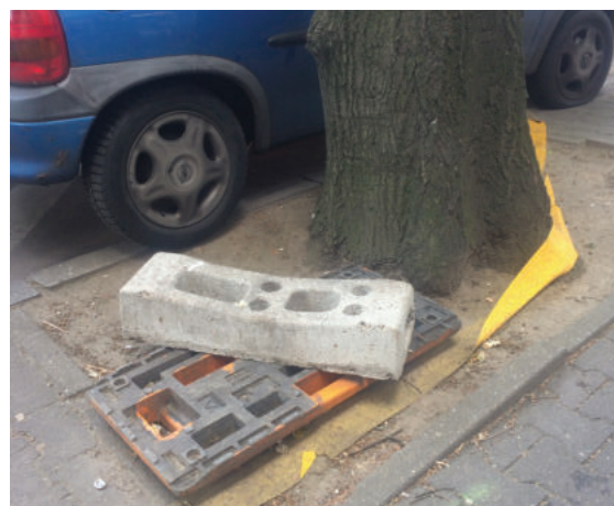
Abb. 3 Stark verdichtete Böden und zu kleine Baumscheiben nehmen den Bäumen die sprichwörtliche „Luft zum Atmen“.
